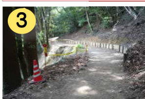
2 0 / 4 0 付近 危険箇所
